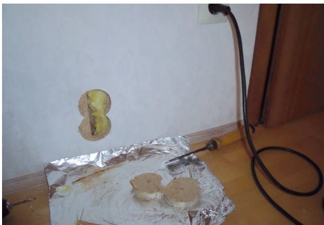
Geöffnete Innenwand: Spanplatte, Holzständer, Mineralwolle ohne Luftdichtung
