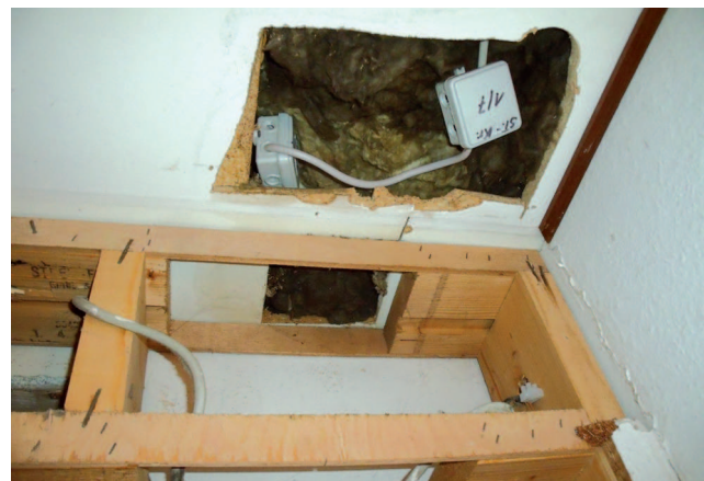
Innenwand und von oben geöffnete Decke – auch hier Mineralwolle ohne Luftdichtung zum Innenraum
