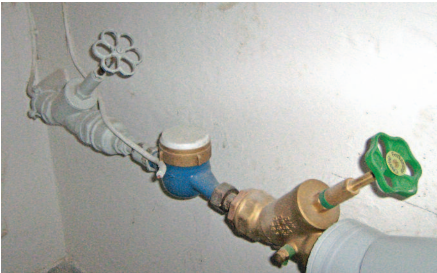
Abbildung 1: Wasser-Hausanschluss eines Altbaus. Bei dieser Altanlage fehlen der Zählerbügel und der Potentialausgleich.
